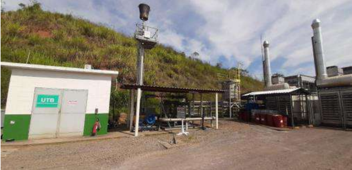
Figura 63: Imagem da área da Unidade de Tratamento de Biogás – UTB.
